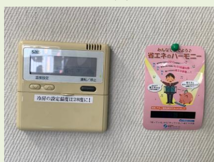
事務所室温の管理
